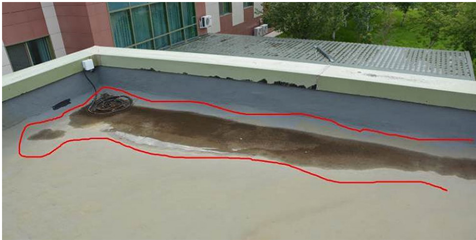
Рисунок 1 – Характерный дефект в виде застоя воды по причине отсутствия соответствующего уклона к водоприемным воронкам
