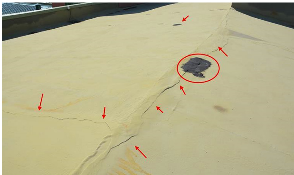
Рисунок 3 – Характерный дефект кровли: участок перехода нового слоя поверх существующего участка выполнен не по регламенту – отсутствует клинообразность области перекрытия
