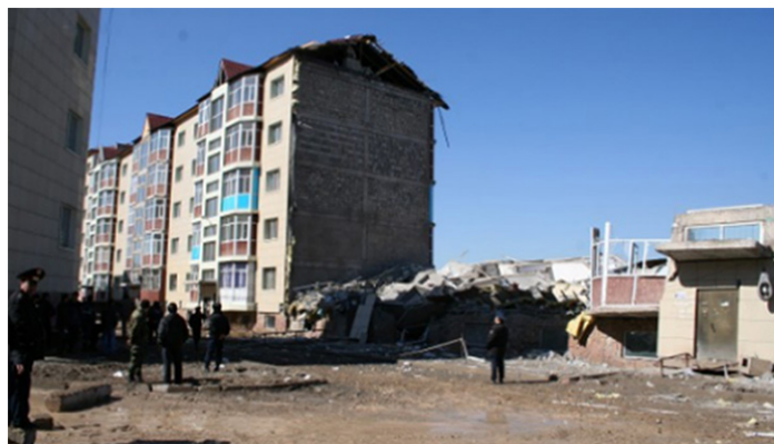
Рисунок 2 – Обрушение здания новостройки в Караганде (04.2012г.)
