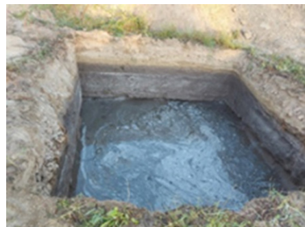
Рисунок 3 – Замачивание грунта котлована
