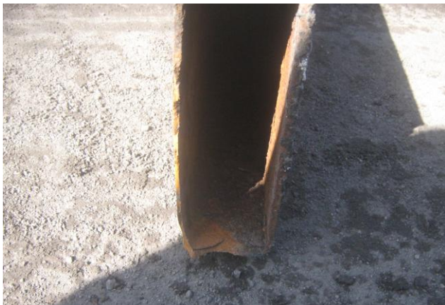
Рисунок 2 – Вид разрушенного нижнего пояса подстропильной фермы
