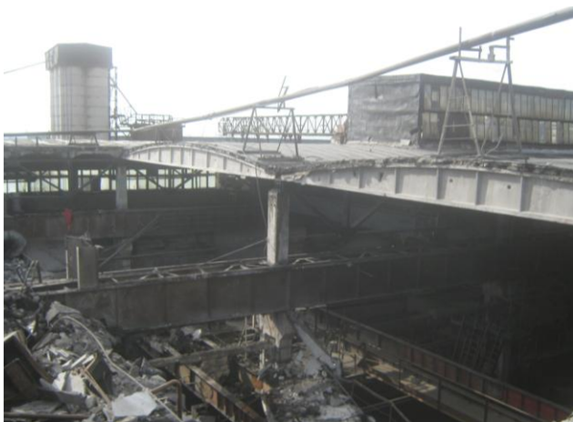
Рисунок 1 – Общий вид обрушения
