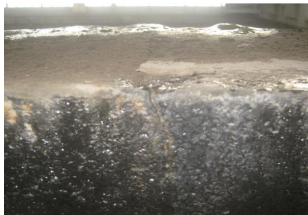
Рисунок 3 – Усталостная трещина в стыке нижнего пояса подстропильной фермы
